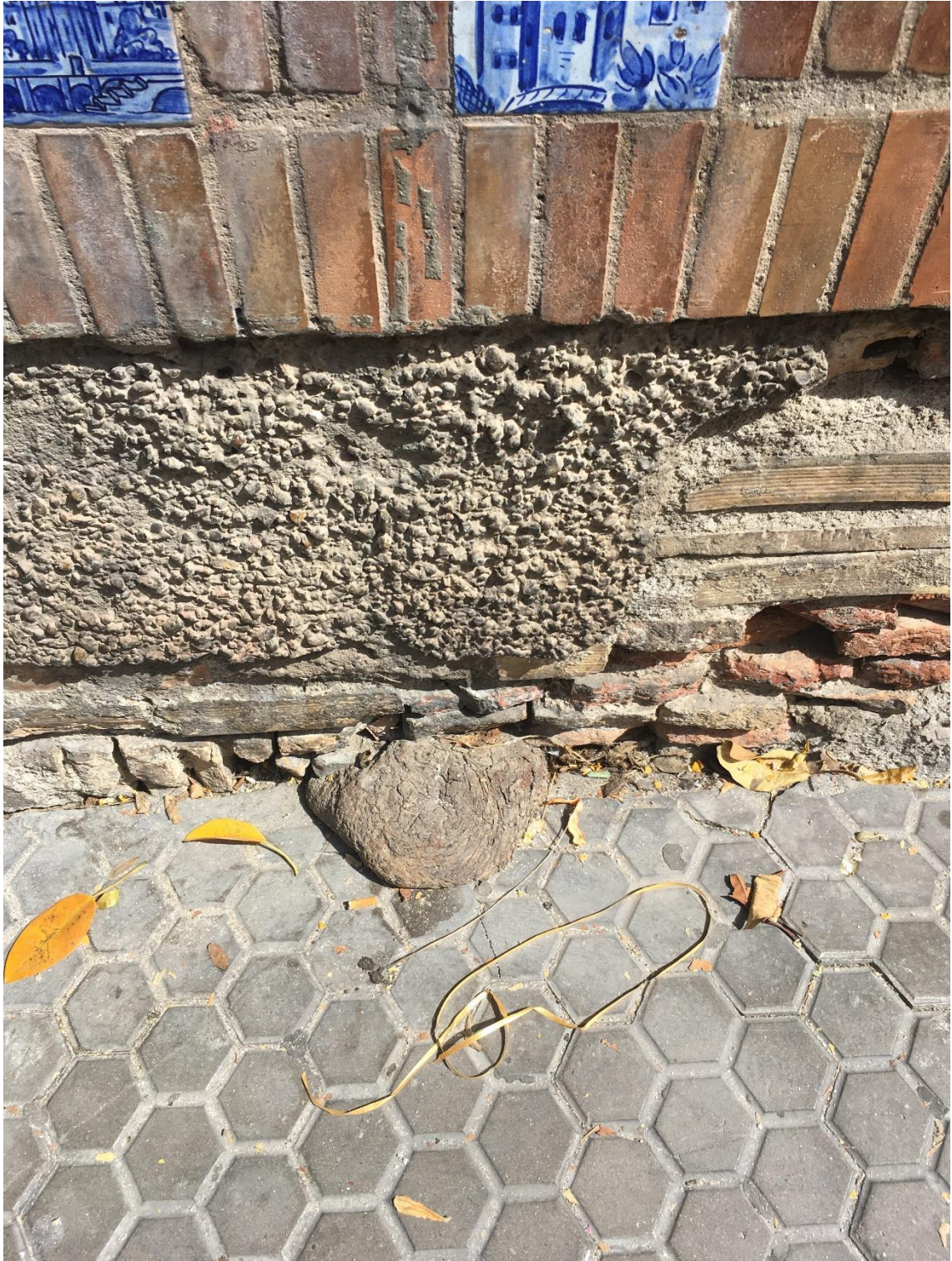
Ilustración 5.- Raíz que aparece por debajo del muro de contención del compás justo delante de la fachada principal de la iglesia.
