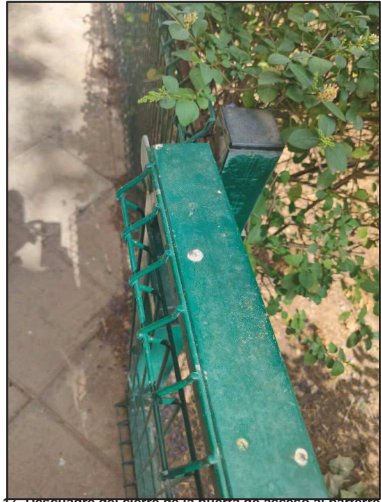
17. Descuadre del cierre de la puerta de acceso al parterre por levantamiento del terreno
