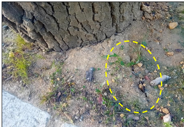
Grieta en el suelo junto al cuello del árbol
