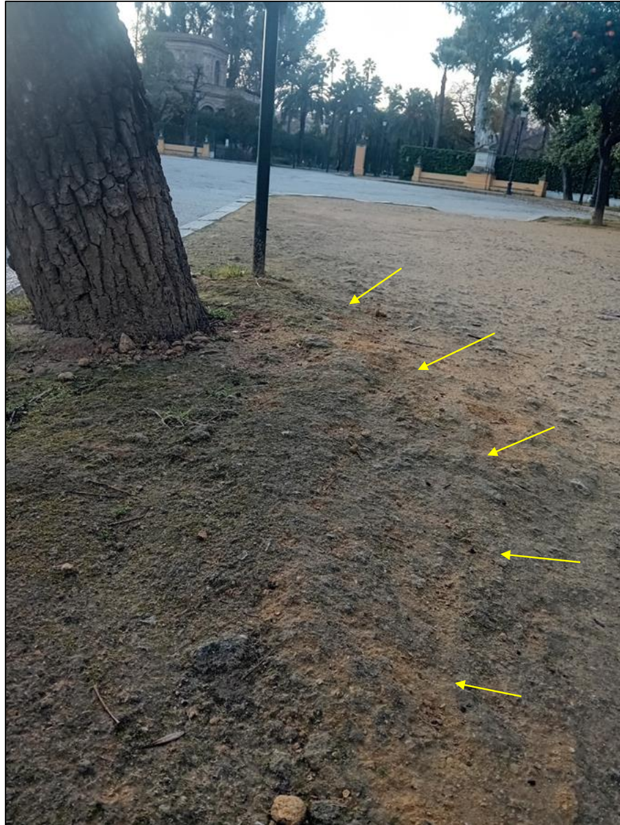
Movimiento en el terreno entre el árbol y el bordillo
