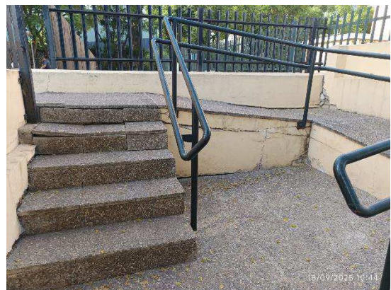
Daños por acción radicular en entrada a Inter comunidad
