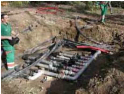
Colector de entrada y valvulería de una de las zonas de riego tipificadas
