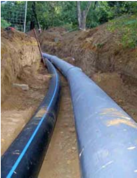
Red primaria de polietileno de alta densidad acompañada por tubería auxiliar de PVC
