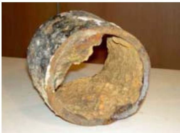
Estado del interior de las primitivas tuberías parcialmente obstruidas por cal y óxidos
