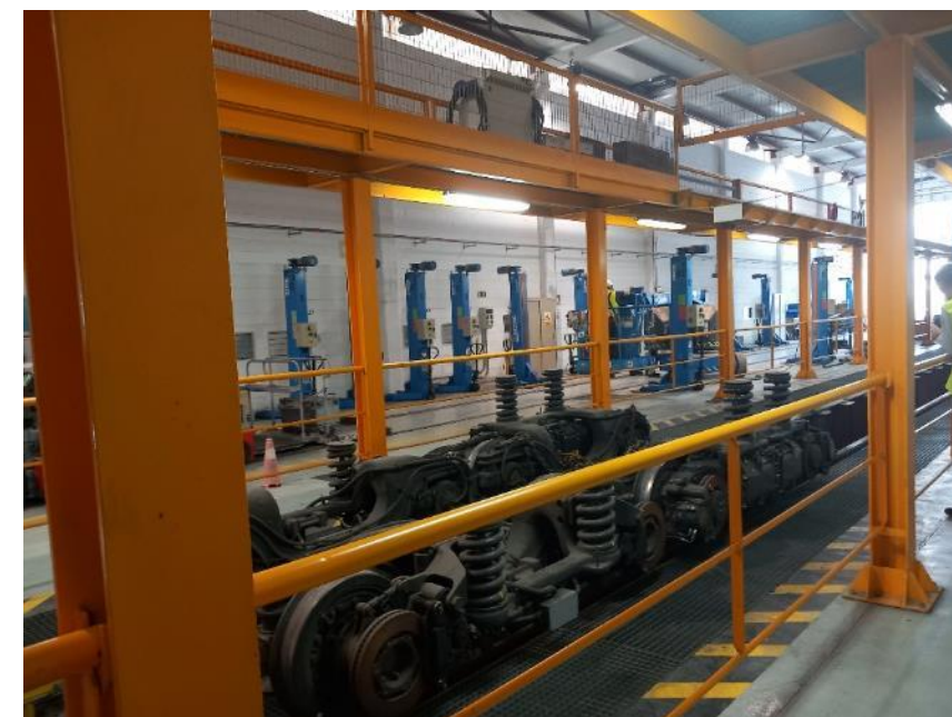
Fotografía 80.- Bogies almacenados en el interior de la vía de inspección. Interior talleres
