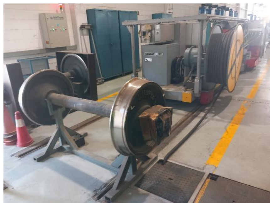
Fotografía 86.- Repuestos y maquinaria interior talleres
