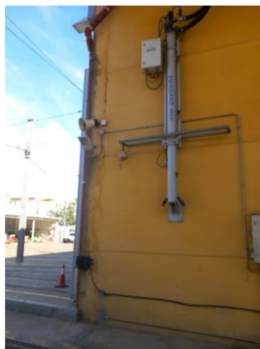
Fotografía 102.- Poste de suministro de arena en cerramiento exterior talleres en vía de lavado
