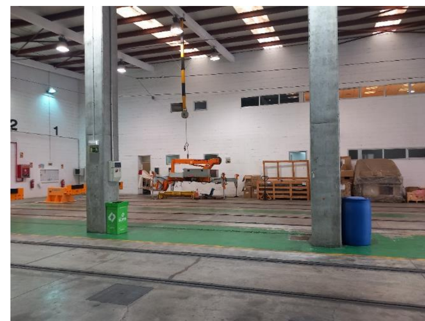
Fotografía 56.- Vista interior de la vía 1-4 en el interior de la nave cochera. Almacén y toperas
