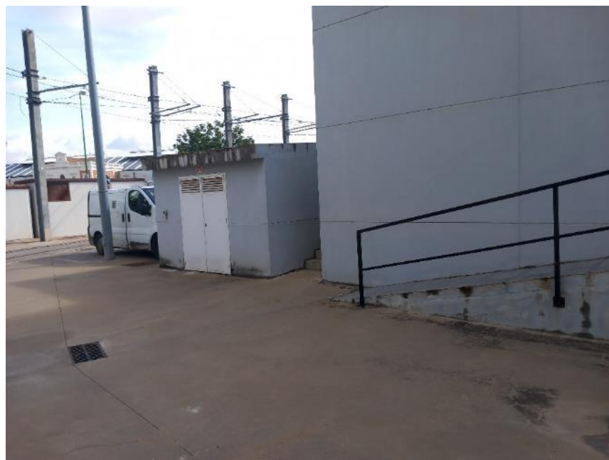
Fotografía 37.- Caseta exterior del grupo de PCI. Junto al edificio de la SET
