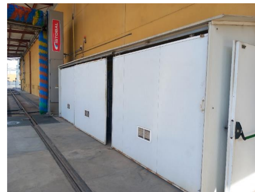
Fotografía 92.- Cuartos de maquinaria de lavado y acceso al taller
