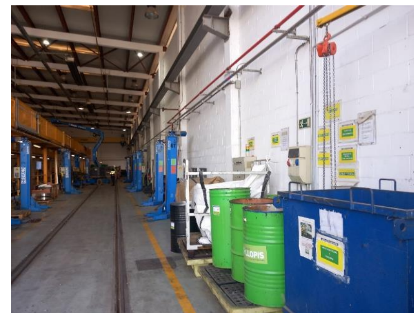
Fotografía 16.- Vista interior de la vía de levante. Zona de residuos
