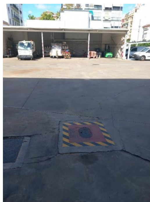
Fotografía 18.- Arqueta PCI, al fondo marquesina y cubrión de la insonorización de la ventilación del edificio de la SET
