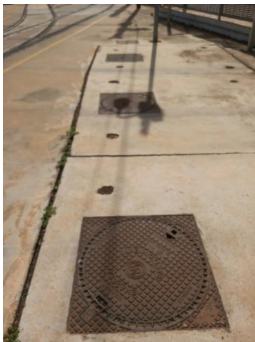
Fotografía 33.- Arquetas de la EDAR (enterrada) situada en la zona exterior de talleres y cocheras
