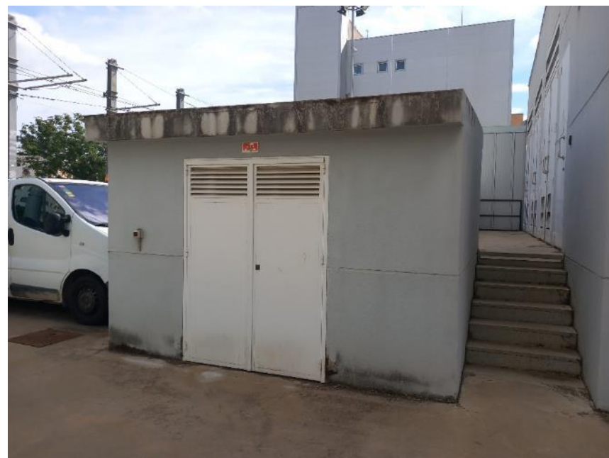
Fotografía 41.- Caseta de grupo de PCI, junto al acceso del edificio de la SET
