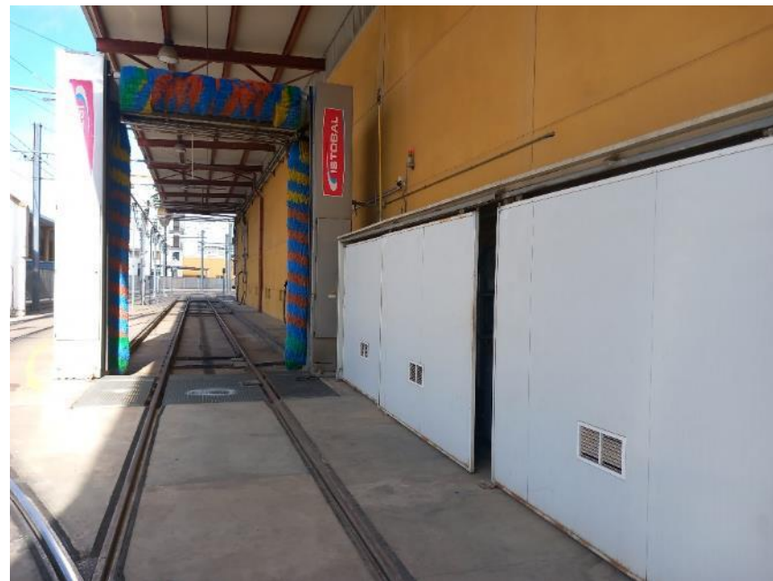
Fotografía 93.- Vía de lavado y máquina automática
