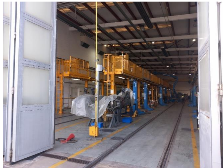
Fotografía 49.- Vista interior de la vía de levante en el interior de la nave taller
