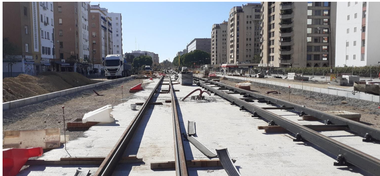
Configuración sección de vía con tablones madera. Ajuste del ancho de vía mediante riostras
